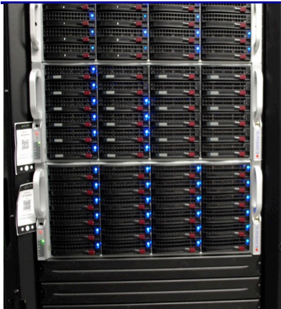
Foto 2: new storage array
